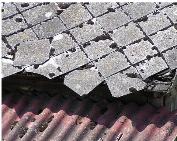
Rys. 8. Pokrycie dachowe ocenione w I stopniu pilności.
