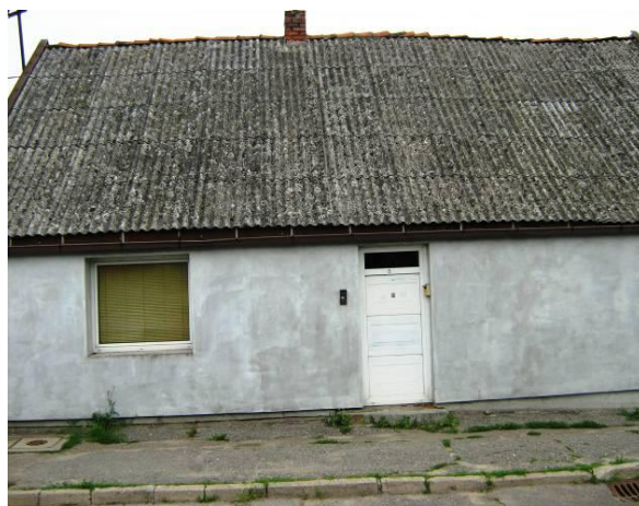
Rys. 7. Pokrycie dachowe ocenione w II stopniu pilności.
