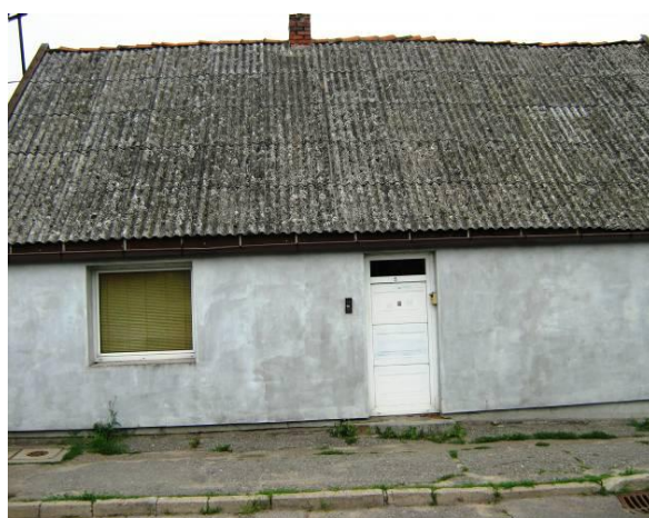
Rys. 7. Pokrycie dachowe ocenione w II stopniu pilności.
