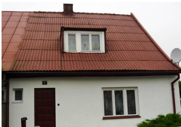
Rys. 6. Pokrycie dachowe ocenione w III stopniu pilności.
