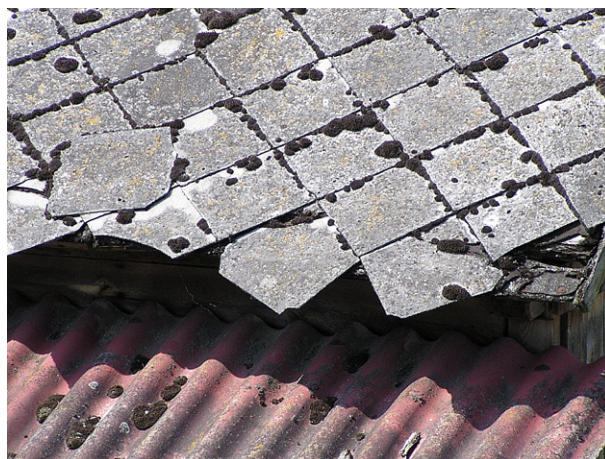
Rys. 12. Pokrycie dachowe ocenione w I stopniu pilności.
