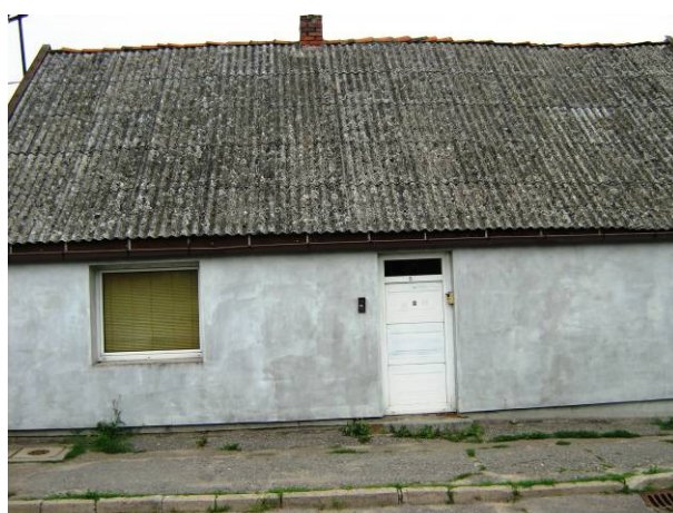
Rys. 11. Pokrycie dachowe ocenione w II stopniu pilności.
