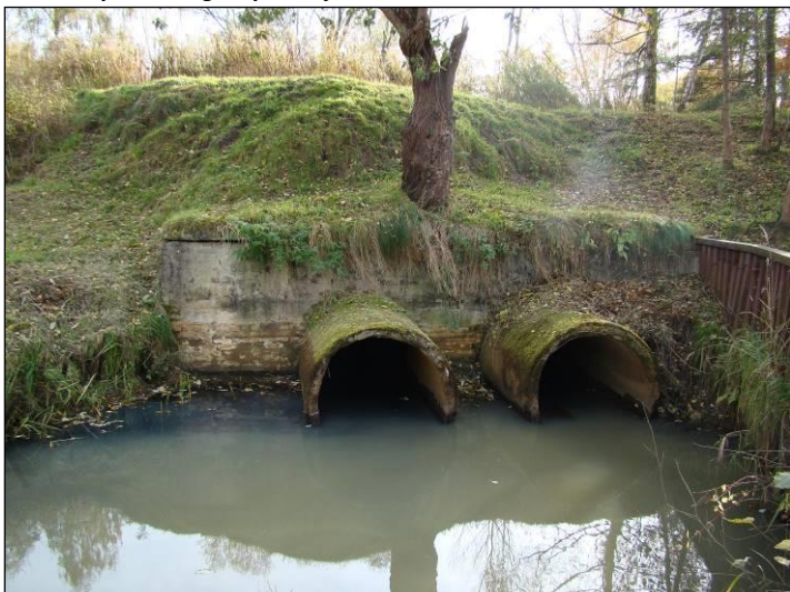
Fot. 18 Wyływ ciek Poleśnica z odcinka zarurowanego
