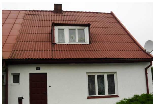
Rys. 10. Pokrycie dachowe ocenione w III stopniu pilności.
