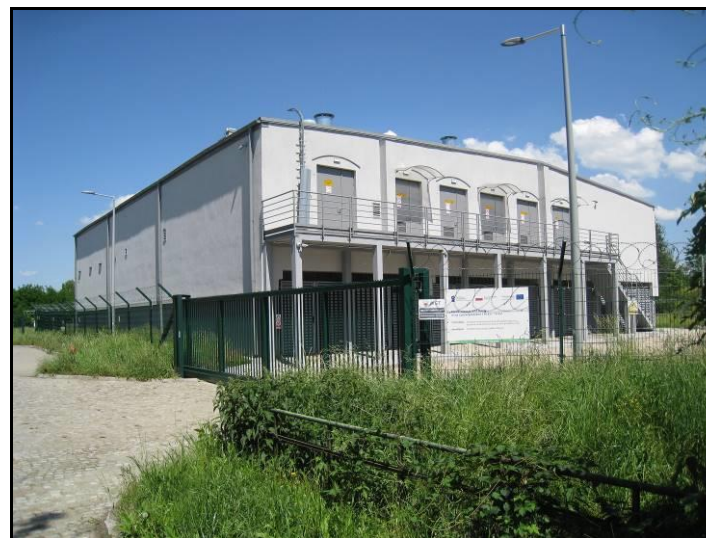
Fot. 1 Tereny stacji elektroenergetycznej na wschód od terenu 1.1
