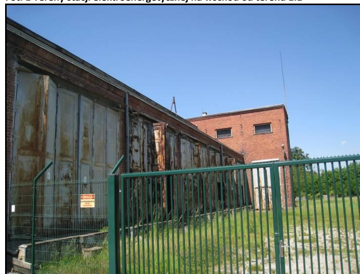
Fot. 2 Tereny stacji elektroenergetycznej na północ od terenu 1.1
