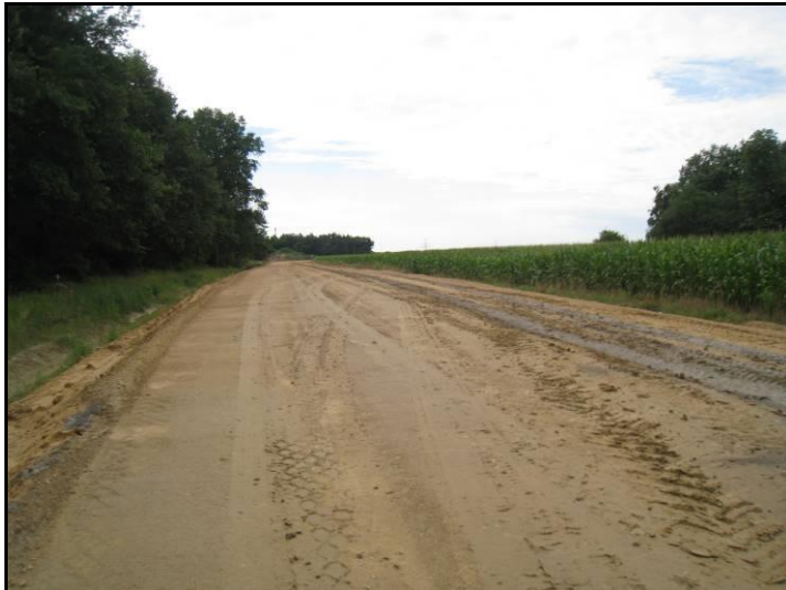
Fot. 2 Nowo budowany łącznik DK40 z ul. Przyjaźni poza wschodnią granicą terenu
