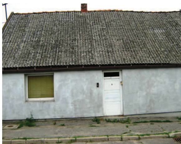
Rys. 7. Pokrycie dachowe ocenione w II stopniu pilności.
