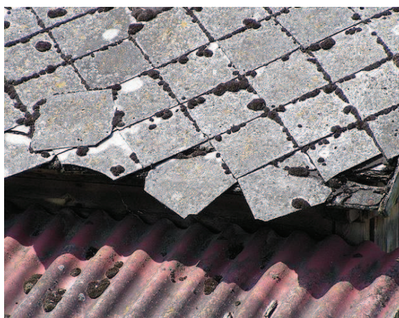
Rys. 8. Pokrycie dachowe ocenione w I stopniu pilności.
