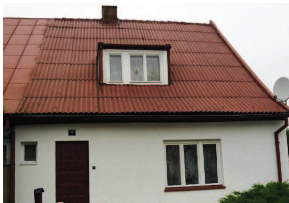
Rys. 6. Pokrycie dachowe ocenione w III stopniu pilności.
